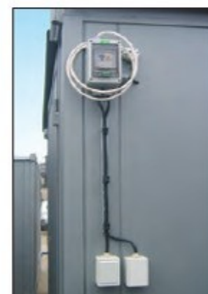
Szczegóły instalacji elektrycznej.
